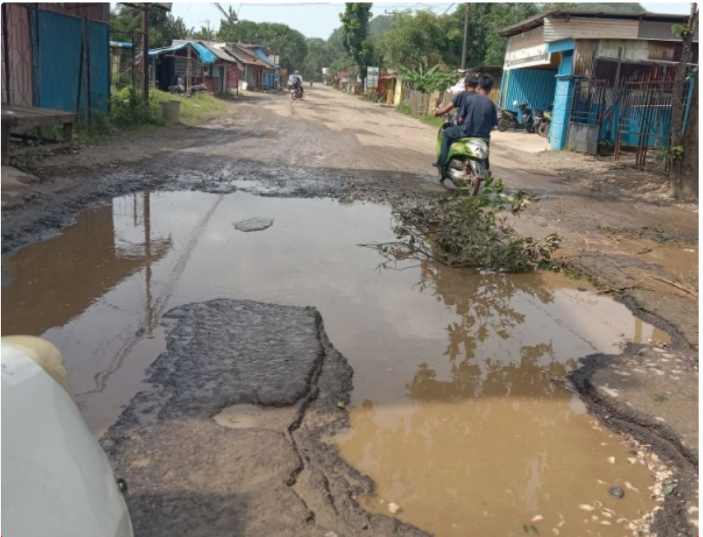
Rusak berat, Kondisi jalan poros Minasate'ne sangat memprihatinkan
