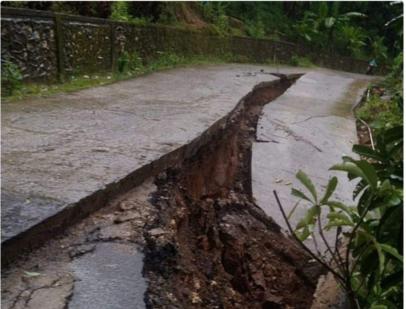
Akses Jalan Poros longsor, Kendaraan Warga Tondong Tallasa Tidak Bisa Lewat Lagi di Desa Malaka
